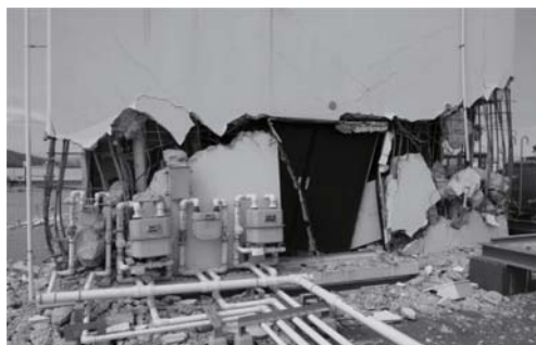
1号館屋上の様子：屋上部は柱、壁ともに崩壊。鉄筋も切れているところが多い。
